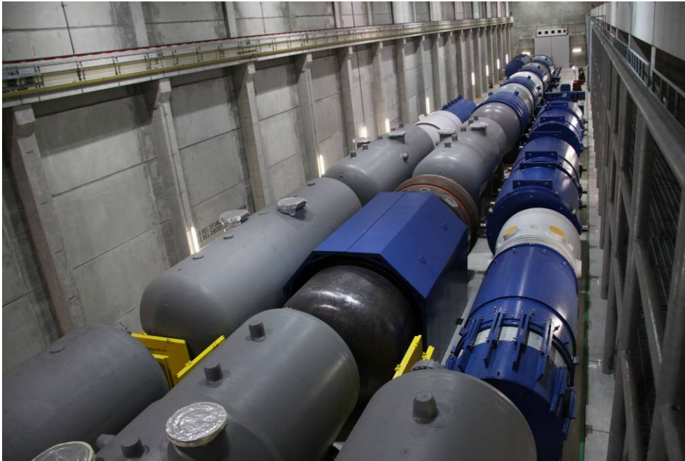
Figur 3.4. Udtjente dampgeneratorer i hal 7.
